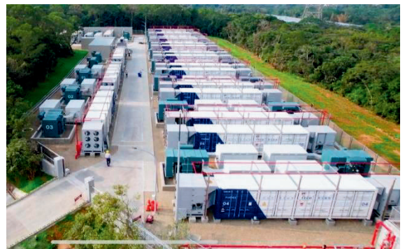
圖 4 台灣電力公司龍潭儲能系統
