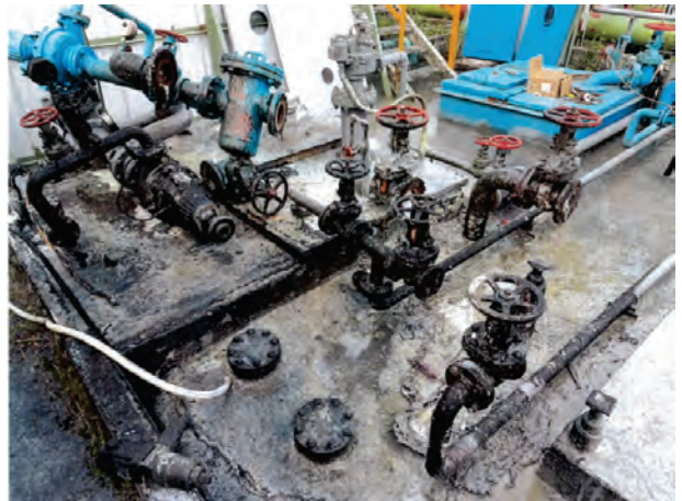
圖 15 石門供油中心火災撲滅後現場
