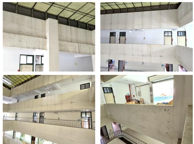
戊山園走廊圍牆裂縫情形
