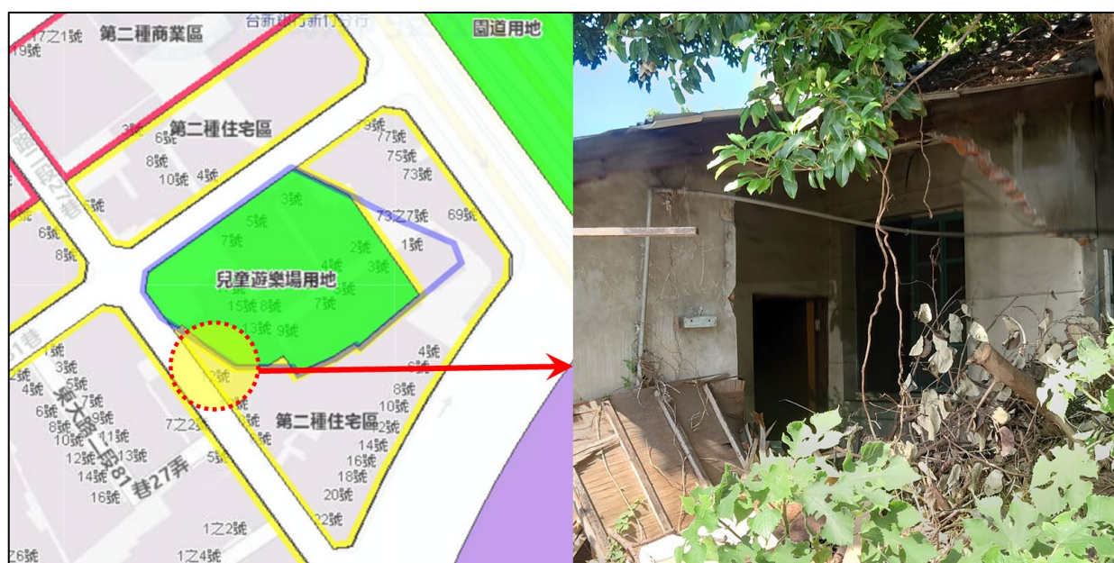
圖 6 新竹市北大段 2400 地號土地長期間置荒蕪且雜草叢生
