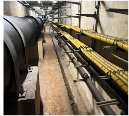
中山一、二路共同管道系統 （圖片來源：基隆市政府提供）
