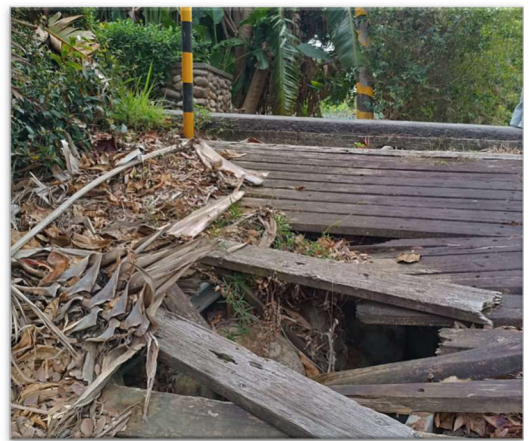
圖 1 自行車道設施損壞情形
