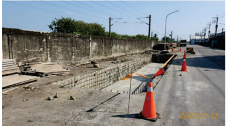
圖 5 臺鐵沿線經管土地遭民間業者施作工程情形
