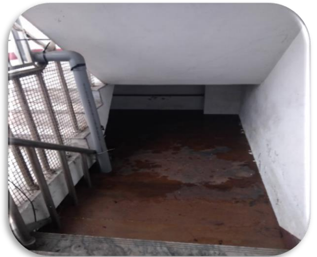
原住民故事館地下 2 樓積水情形
