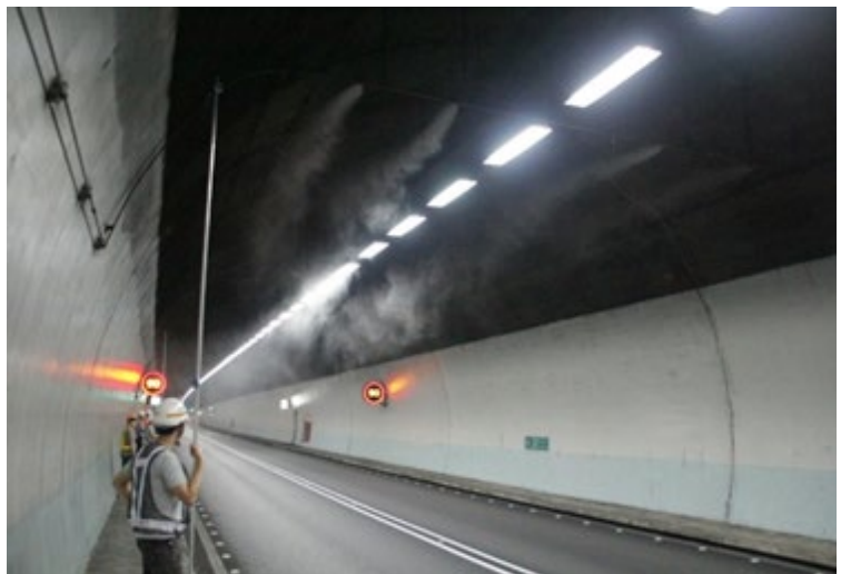
圖 8 雪山隧道噴霧降溫系統測試
