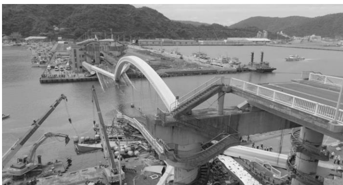
圖 1 南方澳大橋斷裂情形
