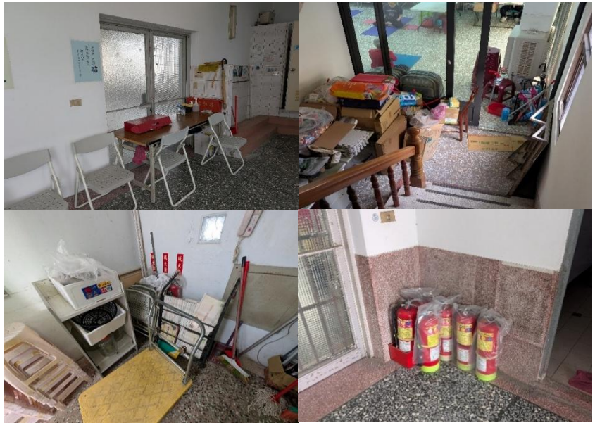
圖 1 里集會所樓梯通道或逃生出入口、滅火器擺放情形
