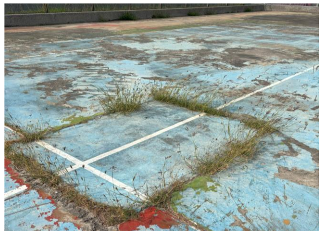
網球場地面龜裂且雜草叢生
