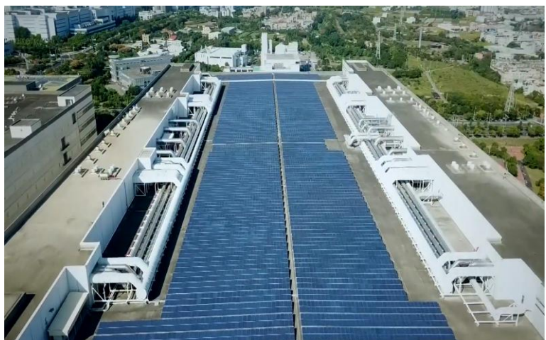
圖 12 科學園區屋頂型太陽光電
