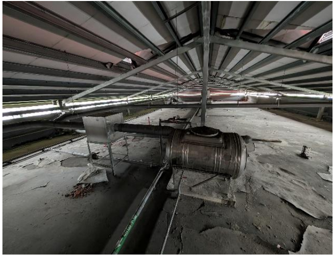
新北市立三重高中透水保水設施儲流水回收系統 屋頂雨水收集及儲流水回收裝置
