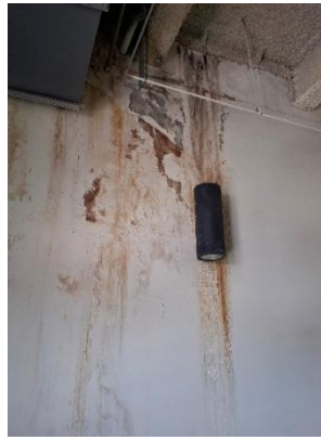
4樓牆壁滲漏水嚴重
