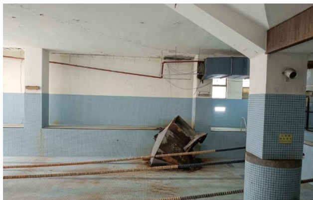
地下 2 樓空調風管鏽蝕損壞
