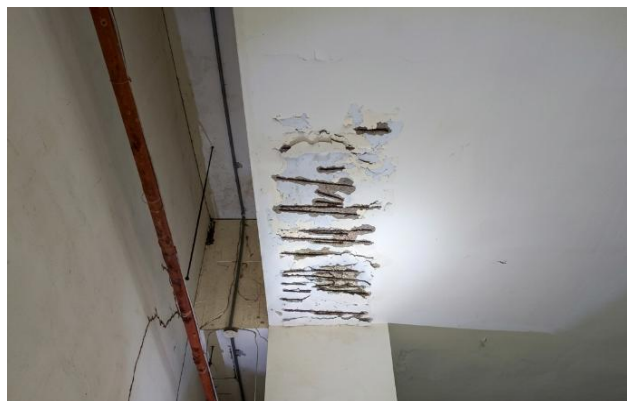
地下 2 樓混凝土剝落鋼筋鏽蝕
