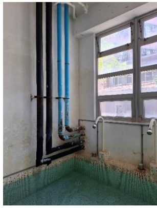
1樓游泳池管線生鏽腐蝕
