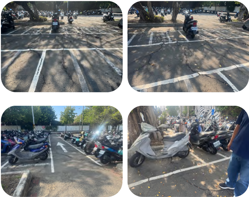
後火車站公有停車場鋪面破損情形
