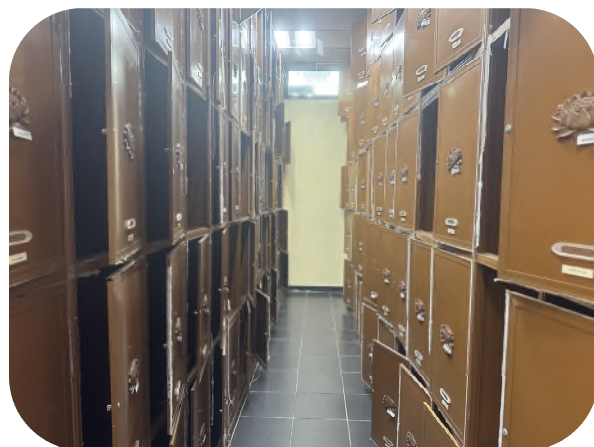
華嚴堂地下室既有櫃位老舊情形
