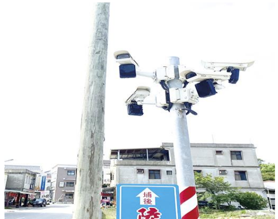
金門縣錄影監視設備
