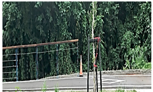
部分自行車道旁護欄及鋼絞線尚未完成施作
