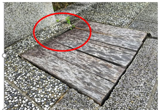
自行車道面板變形凹陷情形
