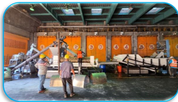
文山焚化廠設置廚餘固液分離機
