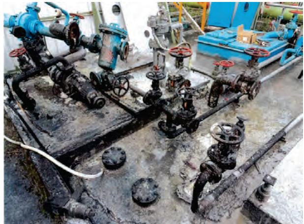
圖 15 石門供油中心火災撲滅後現場
