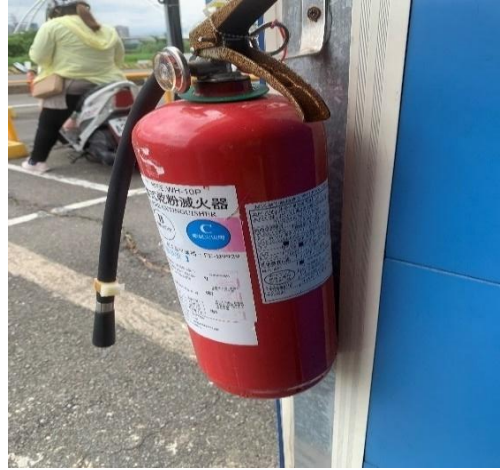
新莊新月橋停車場滅火器壓把已鏽蝕
