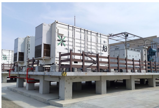
圖 14 臺南鹽田太陽光電場儲能設備
