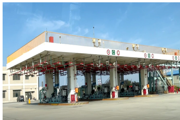
圖 9 LNG 灌裝設施營運情形
