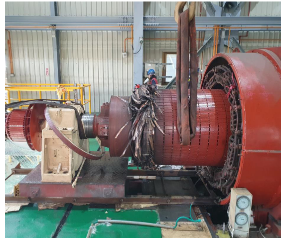
圖 11 No. 19 發電機定轉部繞組線圈損毀情形
