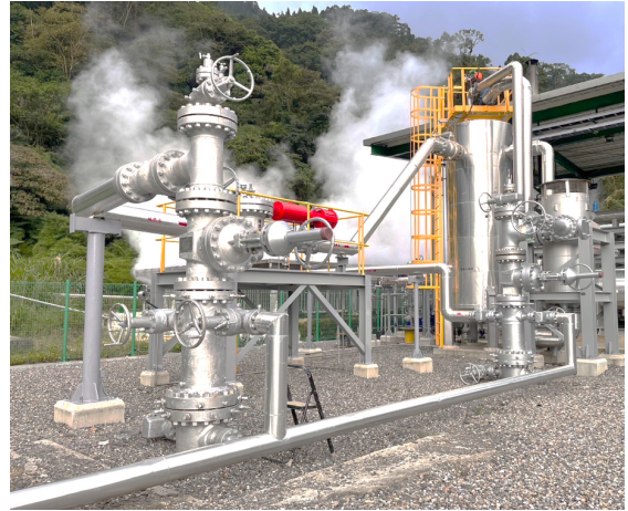
圖 10 仁澤地熱電廠運轉情形
