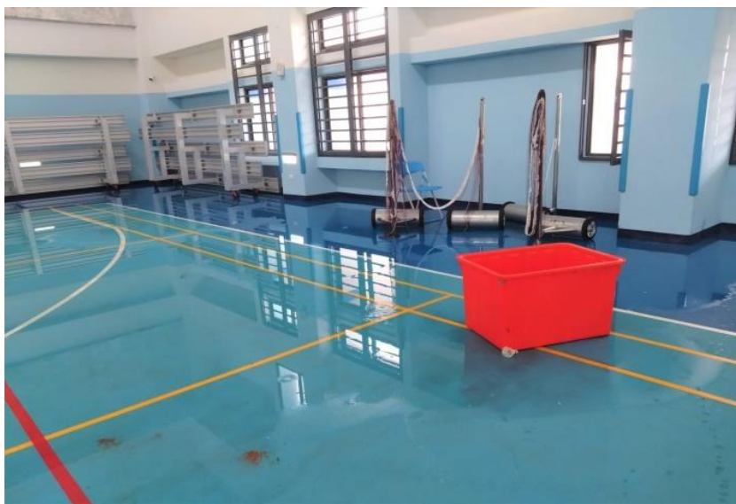
白沙國中多功能體育館屋頂漏水致館內地坪積水情形
