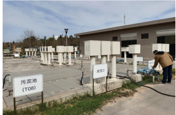
污水處理池槽
