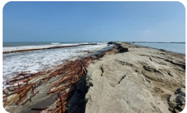
杜蘇芮颱風造成七股區青山港沙洲損壞情形
