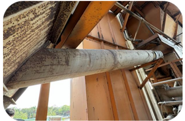
貯料倉、攪拌機之空氣污染防制設備
