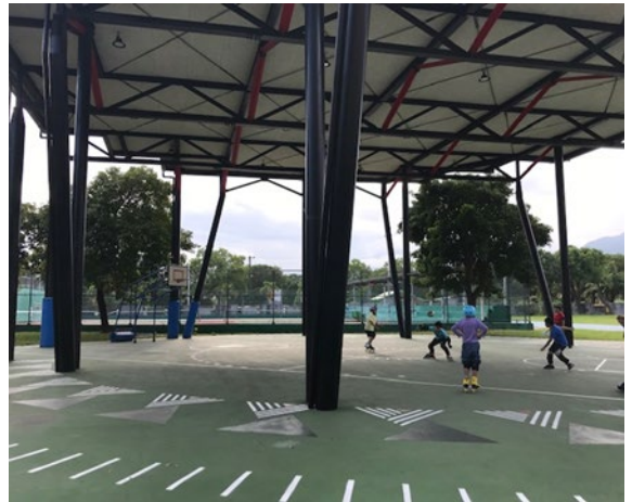
吉寶竿部落聚會所鋼柱欠缺防撞墊保護設施情形
