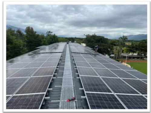
花蓮縣北林國小設置太陽光電情形
