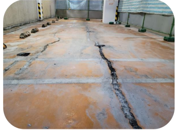
中央公園地下停車場 地下第三層地面滲水無法使用
